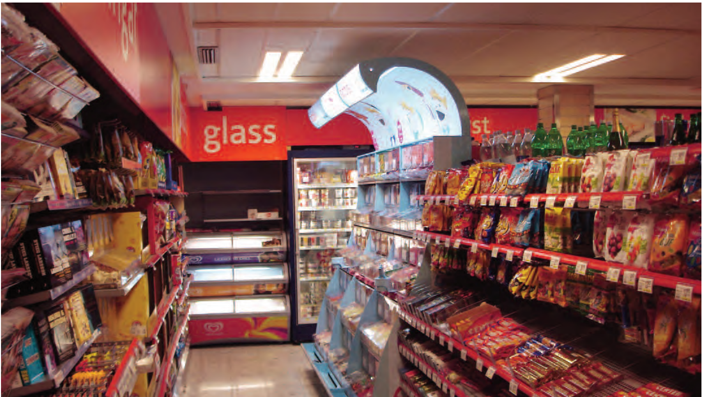
Vid nybyggnationer av ICA-butiker används bland annat dimbara T5-armaturer i ett DALI-system. Armaturerna är indelade i olika zoner för gruppvis styrning mot närvarogivare.
